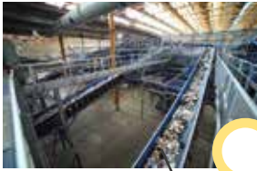
Unité de séparation mécanique
